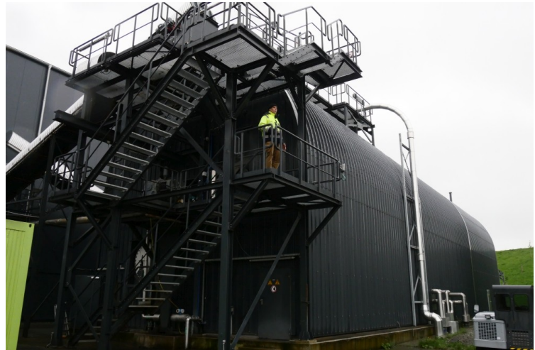
Der riesige Fermenter ist das Herz der Anlage
